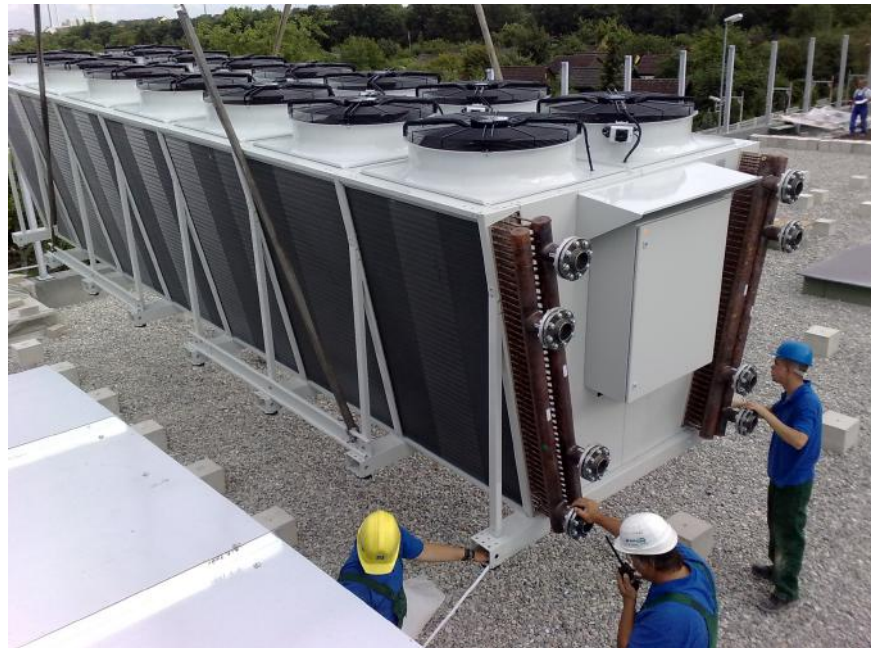
BM Green Cooling hat sich auf die energieeffiziente Klimatisierung und Kühlung von Rechenzentren und IT-Räumen spezialisiert.
